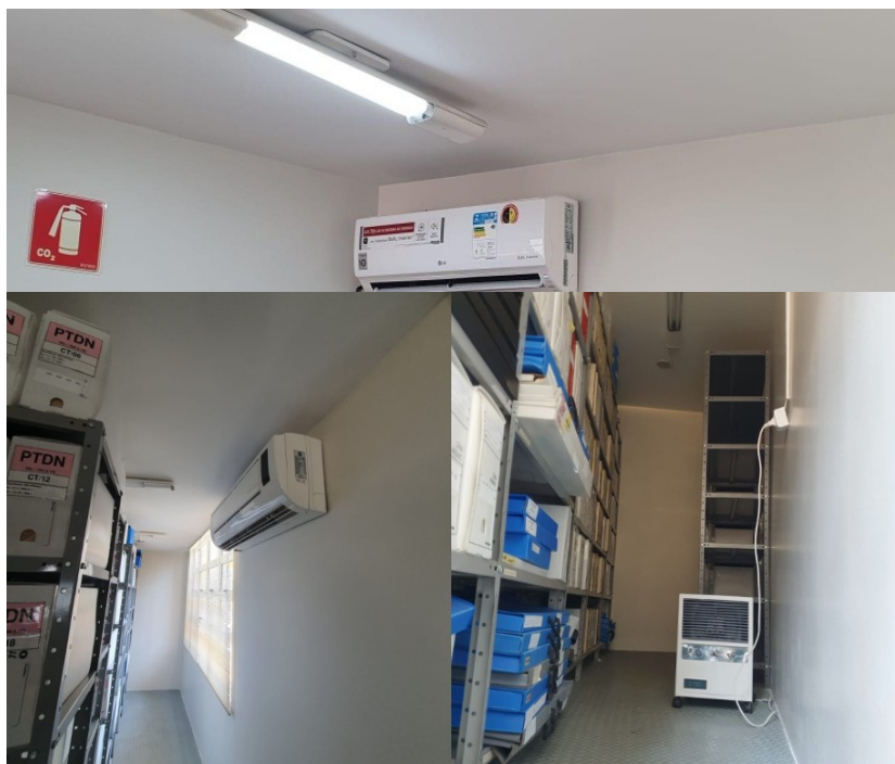
Figura 7. Ar Condicionado Split Reverso Marca LG S4NW09WA5WA 9.000 BTU, localizado na Área 05: Pesquisa e difusão.
