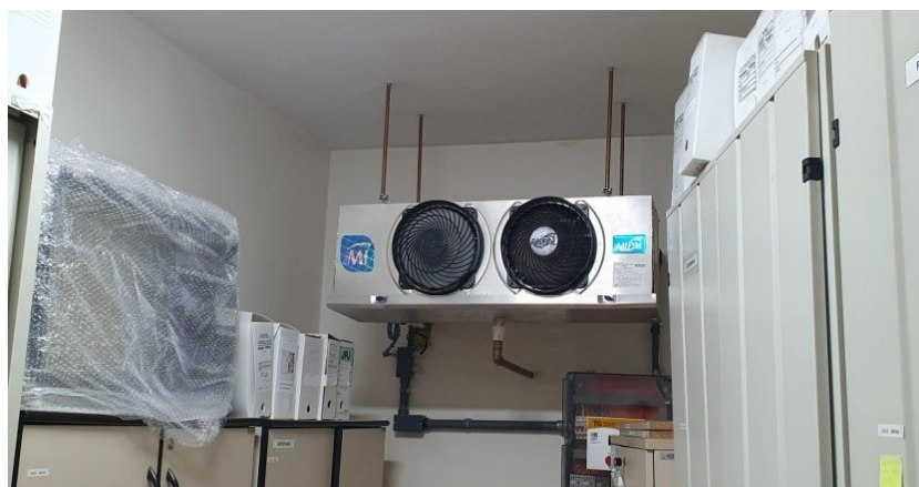
Figura 6. Câmara refrigerada Evaporador com ar forçado: Mi Plus Modelo TGRM1018R - Marca: MiPal. Área 03.
